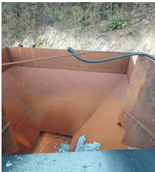
投料口喷淋装置
