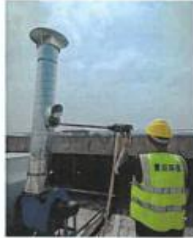
乙醇回收废气排气筒出口
