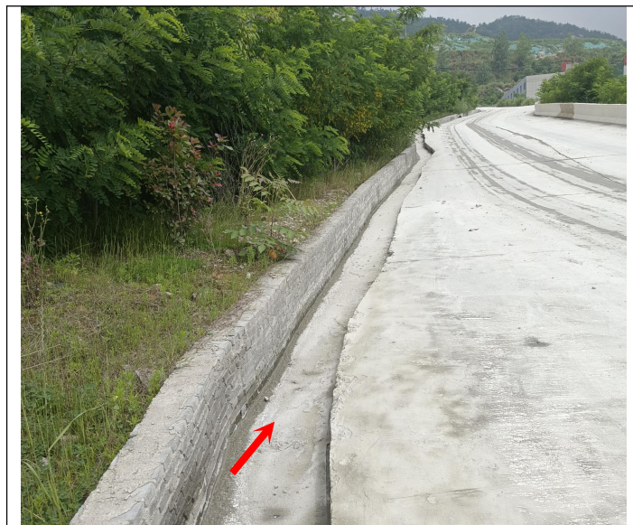
图4-12 项目截排水沟
