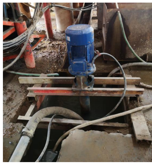
车间废水收集池
