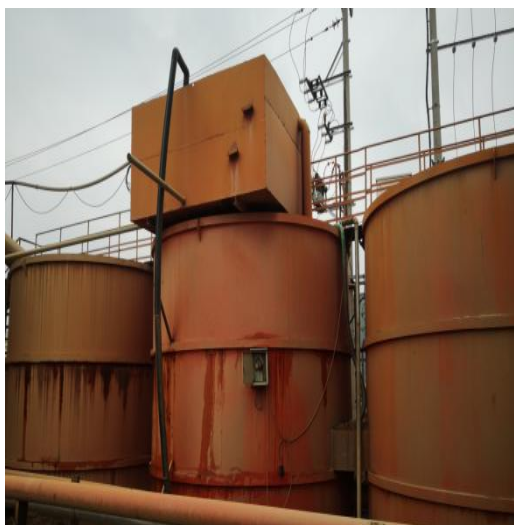
水洗区废水收集池
