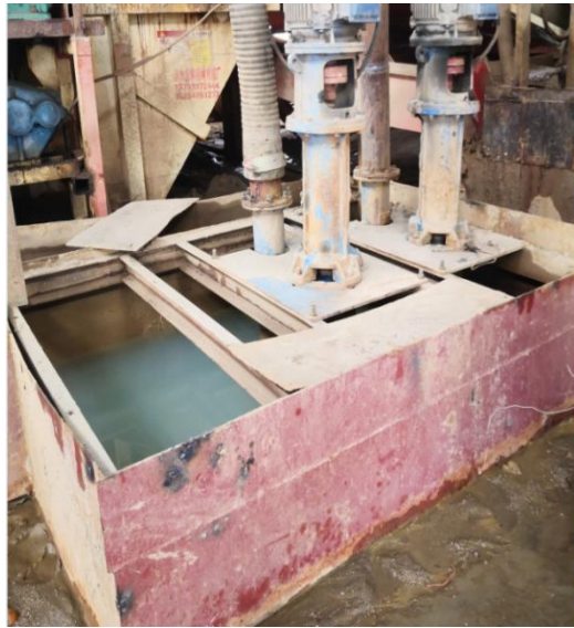
车间废水收集池
