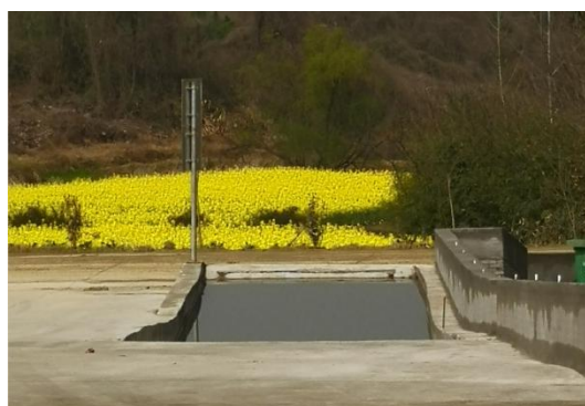
洗车槽及沉淀池
