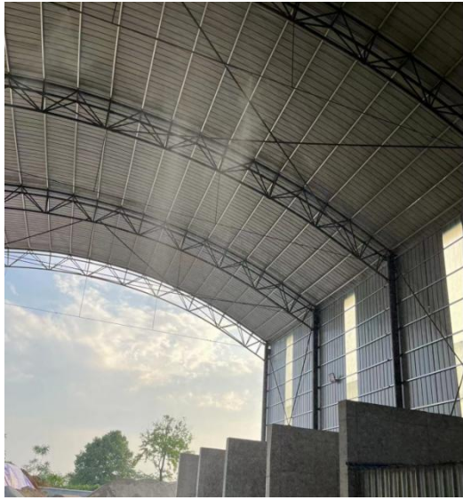
喷雾降尘设施（原料堆场）
