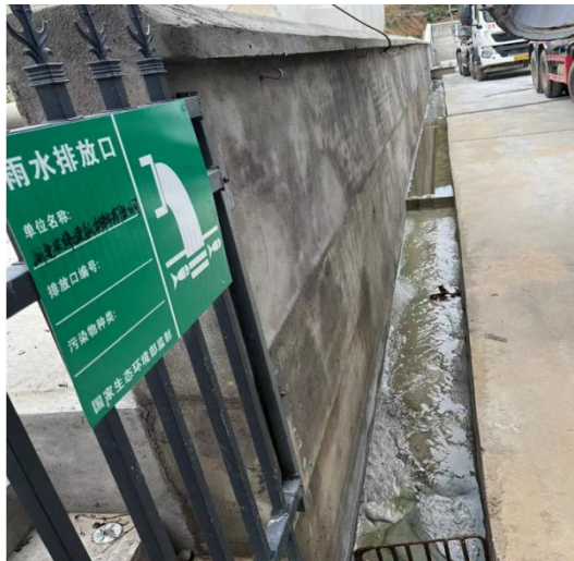
雨水排放口标识牌
