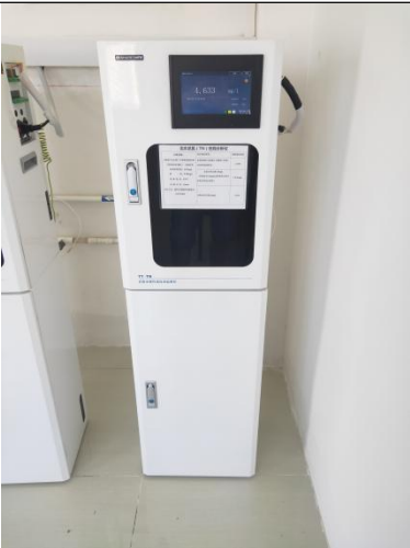
出水总氮在线监测设备
