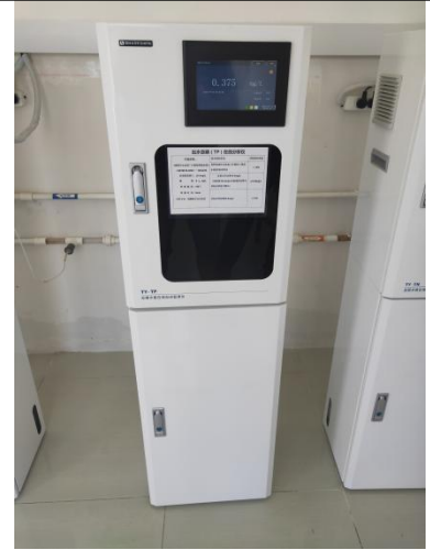
出水总磷在线监测设备
