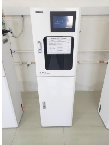
出水NH 3 -N在线监测设备
