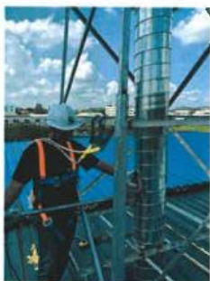
固化废气排气筒出口
