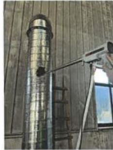
喷漆废气排气筒出口
